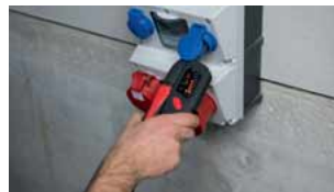
Spannungsprüfung bei Schutzkontaktsteckdose
